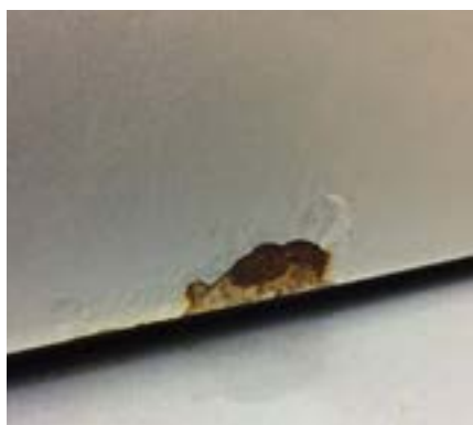
Lackskador som medfört rostangrepp.
